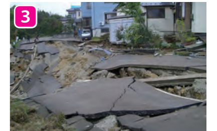
3 高町団地の道路崩壊 長岡市高町付近 出典：新潟県ホームページ「新潟県中越地震の記録」
