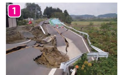
1 (主) 見附橋尾線の崩壊 見附市本明町付近 出典：新潟県ホームページ「新潟県中越地震の記録」
