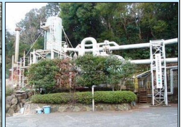
図7 杉乃井ホテル地熱発電所 (ecocommunity.jp.com)
