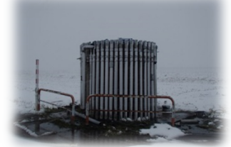
▲金山地区(朝日町)の地下水を利用した簡易水道施設(現地にて撮影)
