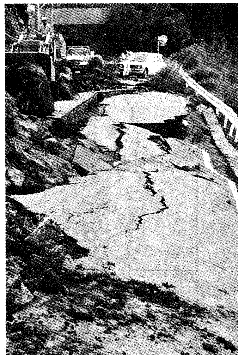
写真2.1 南伊豆の道路は至るところで破断 地震対策と災害復旧工法より
