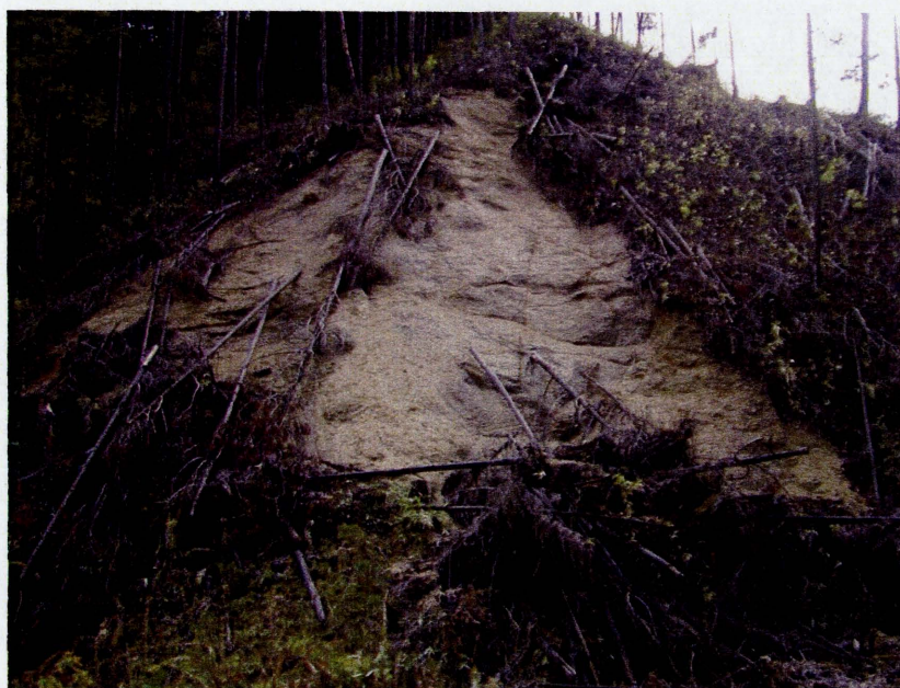
写真2-26 木ノ実峠に至る旧道沿いにみられる表層崩壊地
