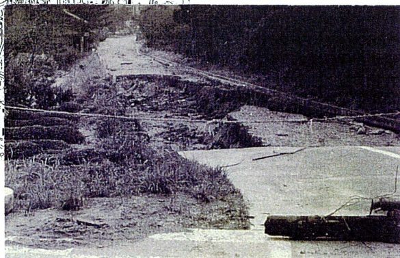
■道路決壊（池新田・小学校前） <写真④>
