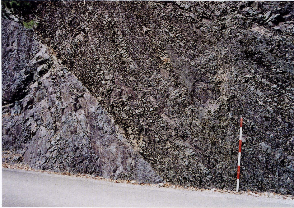
⑦ 奥大道大滝。泥岩勝ち砂岩泥岩互層（黒～黒灰色部）と砂岩勝ち砂岩泥岩互層（暗灰色部）両層とも小岩片状に崩れ易い。
