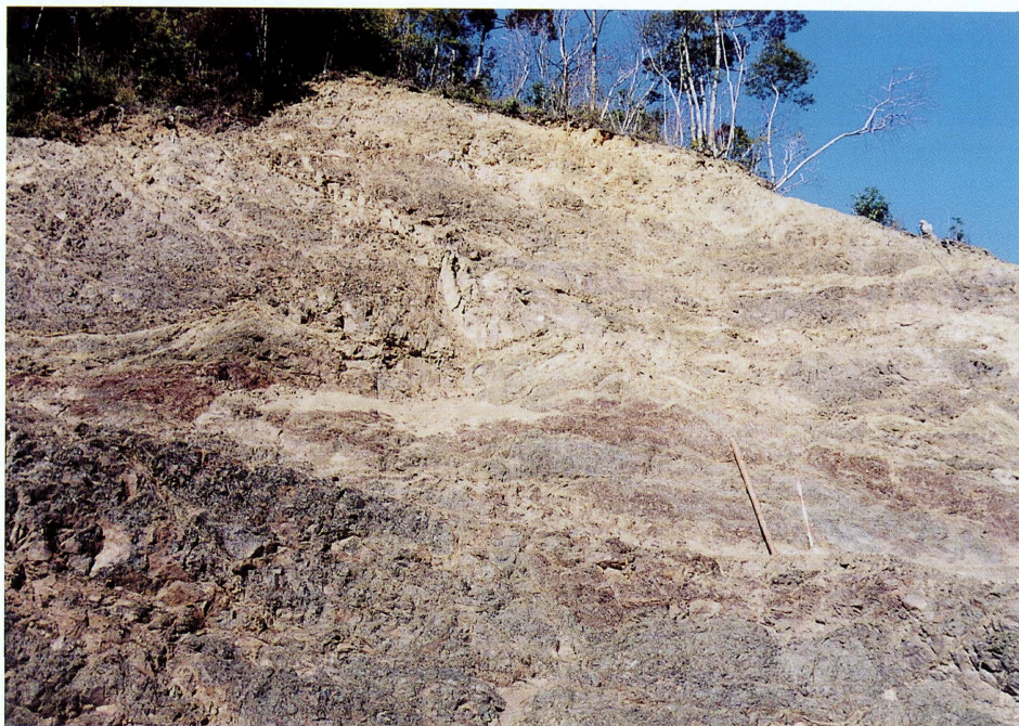
① 川口梁瀬。頁岩は黒～黒灰色でせん断を受け、細片状に剥離しやすい。
