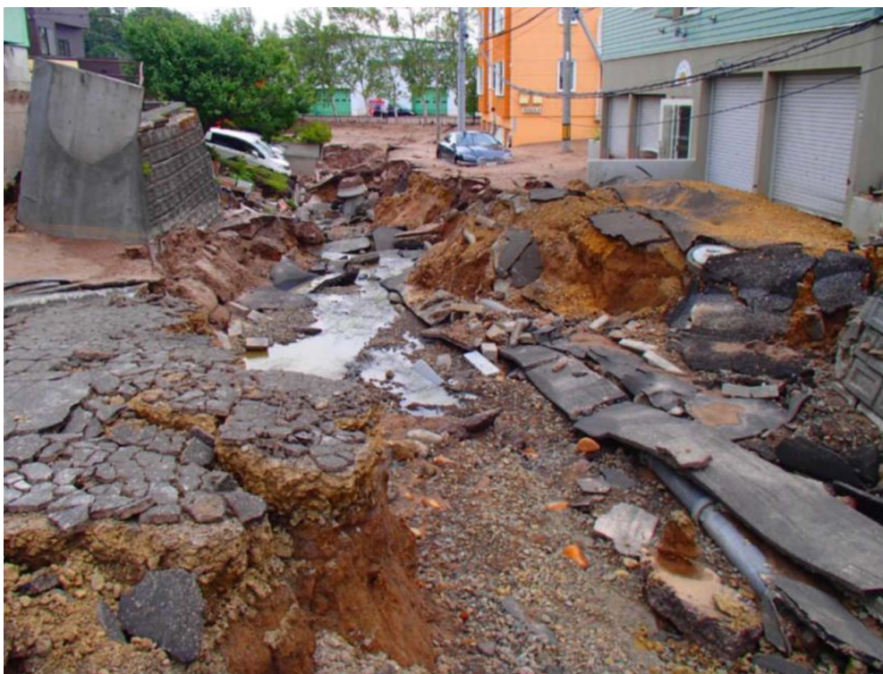
写真 5-1 液状化による沈下と土砂の流動による堆積
