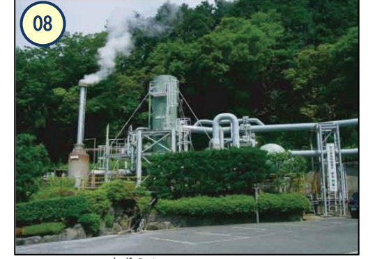
杉乃井地熱発電所
